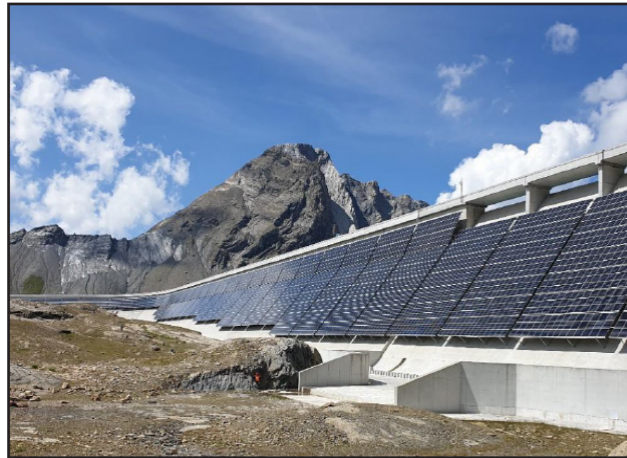
Anlage der Axpo am Muttsee auf knapp 2500 m Höhe
